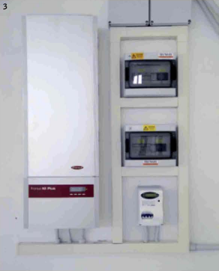
3. INVERTER E QUADRI. La centralina inverter collegata alla rete Enel con contatore bi-direzionale della lettura dell'energia.
